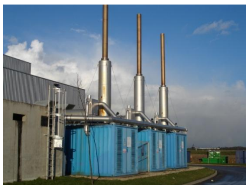
Figure 3 : groupes électrogènes - source SIVOM
