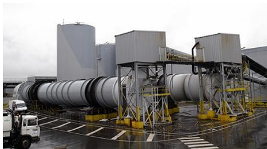
Figure 1 : Bio Réacteurs - source SIVOM
