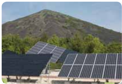
Inauguration centrale solaire
