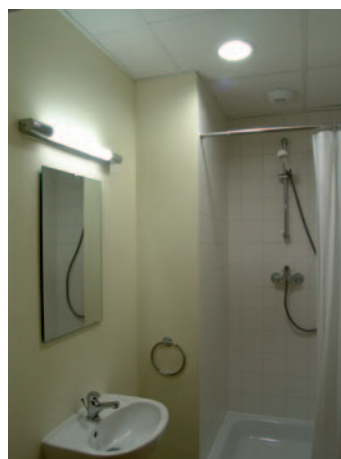
Fig. 61 Eclairage dans une salle de bains.
